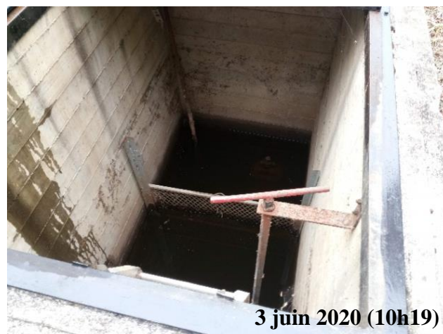
Figure 2. Vue de la fosse où un procédé à deux dégrillages et une crépine submergée envoi l'eau à la première station
